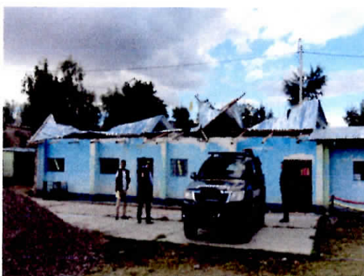
AULAS DE INSTITUCIÓN EDUCATIVA CON TECHOS COLAPSADOS COMO CONSECUENCIA DE LOS FUERTES VENTARRONES EN EL AA.HH MOLLEPATA
